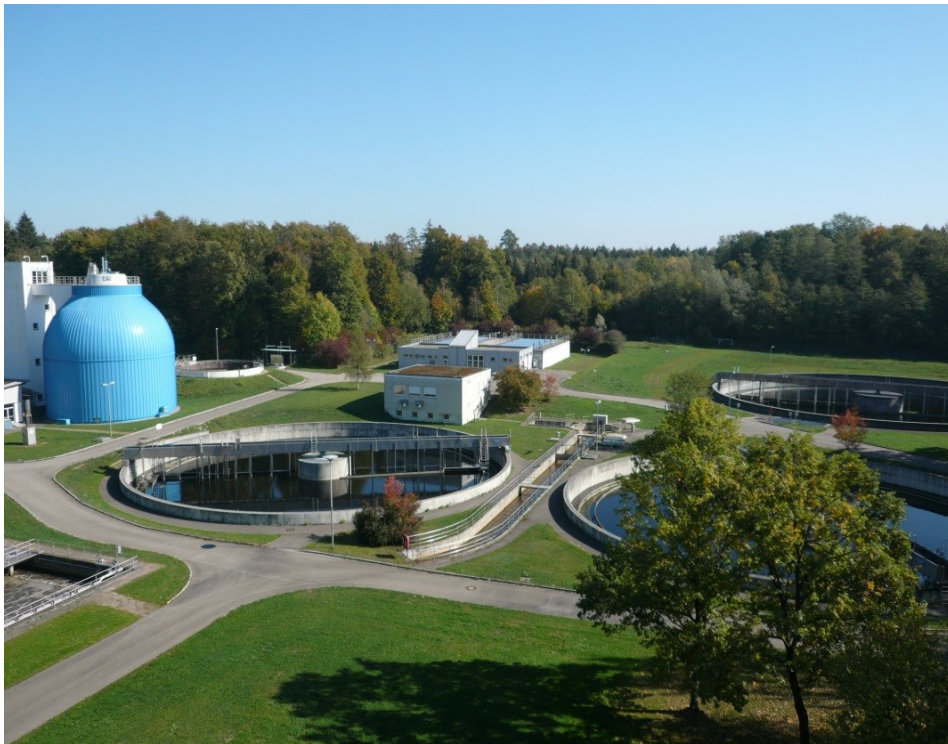
Faulbehälter und Nachklärbecken im Klärwerk
