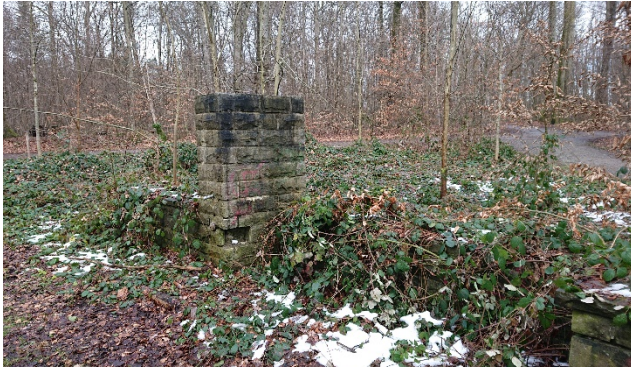
Abbildung 14 Der von Brombeeren überwucherte Brunnen im Riedlewald vor der Restauration des Gemäuers. Aufgrund fehlender Abdeckplatten konnte Wasser ins Mauerwerk eindringen. Foto: Februar 2021
