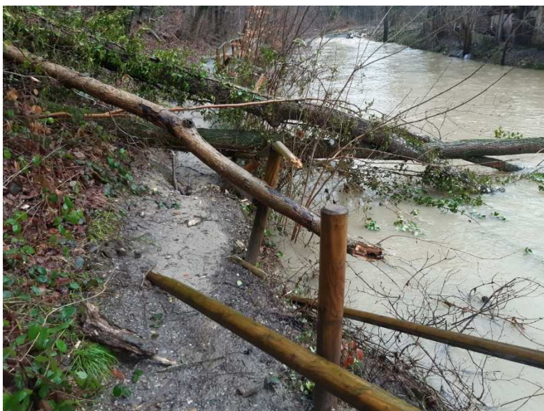
Abbildung 11 Der Rotach-Wanderweg nach dem Hochwasser von Ende Januar 2021. Auf dem durchnässten Hang des angrenzenden Waldes konnten die Wurzeln einiger Bäume keinen Halt mehr finden. Der Naturpfad wurde während des Hochwassers überspült und weist Auswaschungen auf. Foto vom 03.02. 2021.
