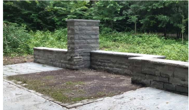
Abbildung 15 Um das Bauwerk zu erhalten wurden fehlende Abdeckplatten und Mauersteine ersetzt sowie Fugen abgedichtet. Moos und Schmierereien wurden entfernt. Foto: Juni 2021
