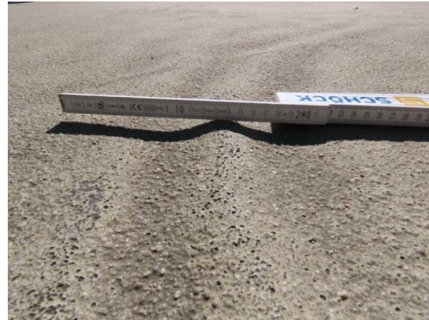
Rampenbereich Verwerfungen im Asphaltbelag
