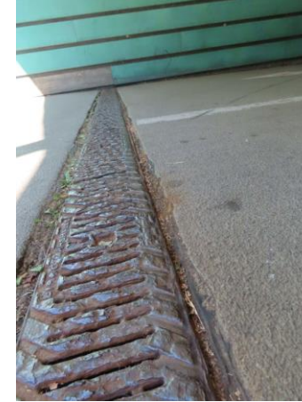
Stark korrodierte Gitter der Entwässerungsrinnen und Asphaltfugenschäden
