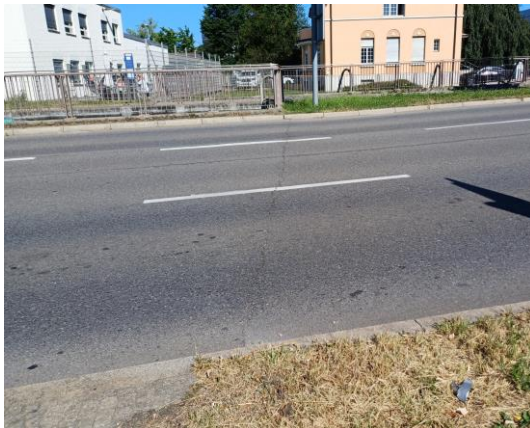
Fahrbahnbelag gerissen aufgrund fehlender Querfuge
