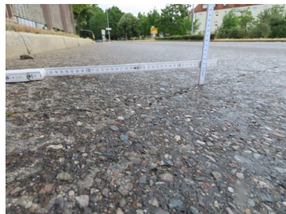
Spurrillen im Fahrbahnbelag
